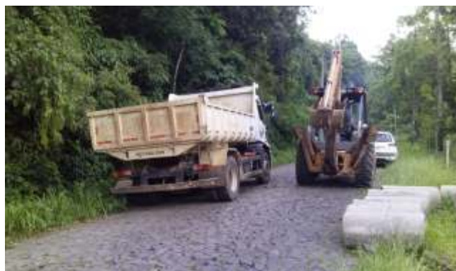
Foi realizado, na Estrada Geral das Águas Brancas, terraplanagem e colocação de canos de concretos
